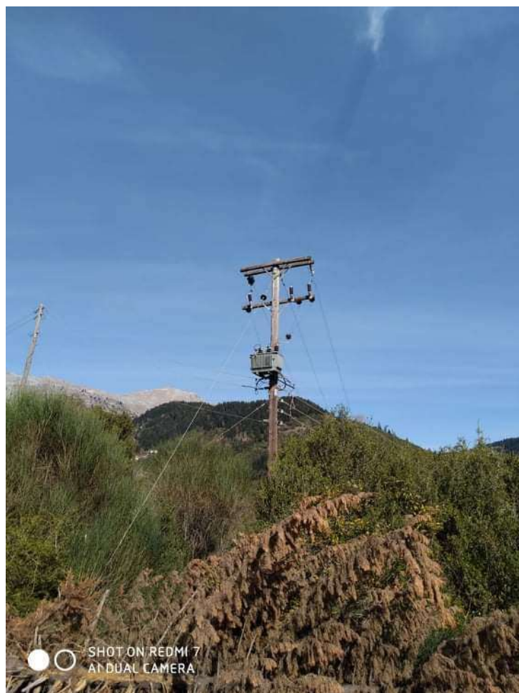
Φωτ. 4: Σημείο σύνδεσης με το δίκτυο Μέσης Τάσης της ΔΕΔΔΗΕ
